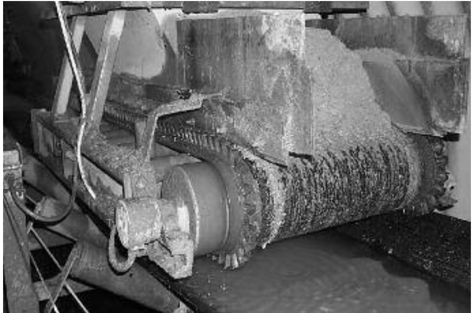
Lavorazione di inerti derivati dal mare, ambiente umido, salino ed aggressivo! La tenuta IP66/67 è un MUST – spesso anche con tenute reingrassabili!
